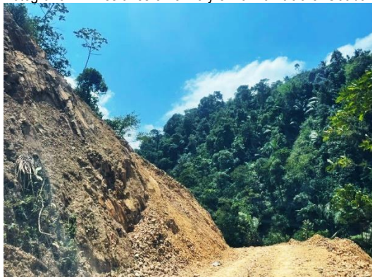
Fotografía 14. Deslaves en el río y en la vía hacia el Guadal
