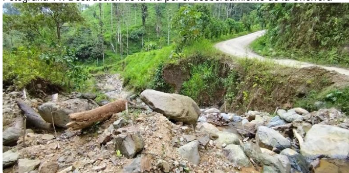
Fotografía 11. Destrucción de la vía por el desbordamiento de la Chorrera
